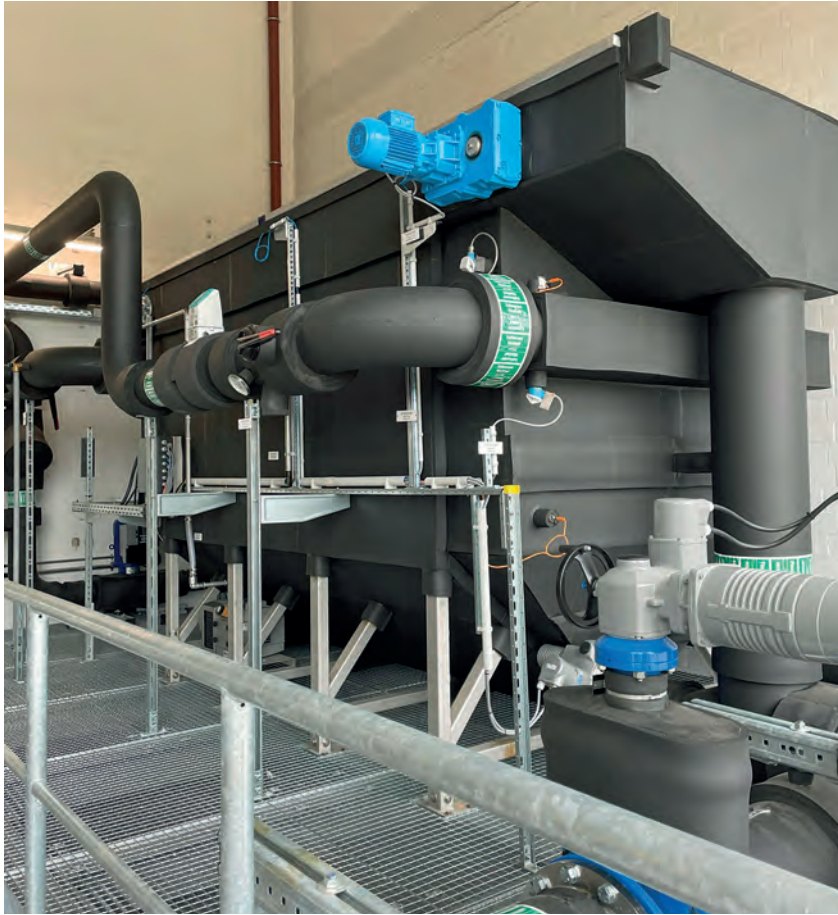
Bild 2. Der Flusswasserwärmeübertrager wurde aufgrund der Statik im Erdgeschoss des Kesselhauses auf einer Stahlträgerkonstruktion platziert. Ein zusätzlicher Ablaufbehälter befindet sich darunter im Keller
