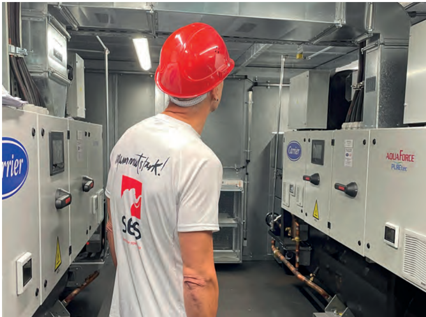
Bild 3. Die beiden Wärmepumpen sind in einem schallgedämmten Maschinenraum oberhalb der Kesselanlagen im Heizkraftwerk aufgestellt
