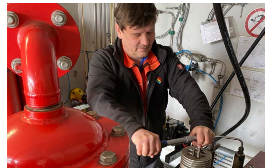
Die Stadtwerke haben in Wittenberge rund 3.500 Hausgasanschlüsse, deren Wartung und Kontrolle zu den Aufgaben von Heiko Siesing gehören.
